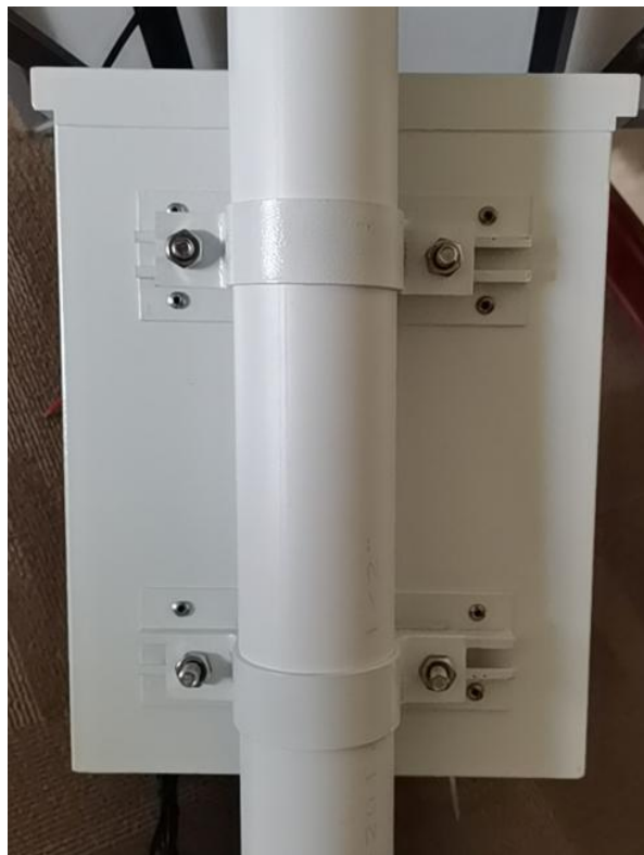
安装完成背面图
